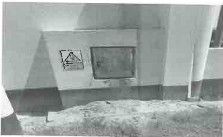
Zona de Ubicacion: Ubicacion de Caja de fuerza de control de iluminacion
