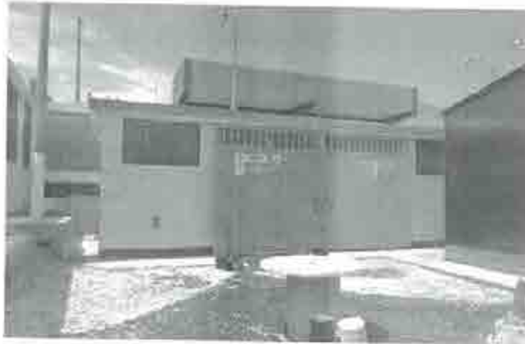
Zona de Ubicacion: Subestacion Eléctrica
